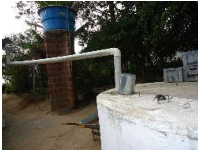
Figura 1: Cisterna com água de captação de chuva vinda do telhado da casa e da estrada.
