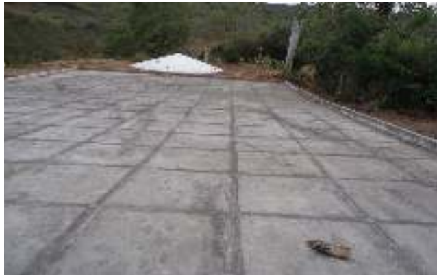
Figura 2: Cisterna calçadão com uma calçada de 200 m 2 , capaz de acumular 52.000 litros de água.
