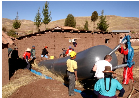
FIGURA 3. Biodigestor de PVC provisto de doble salida, para el sobrenadante y los sólidos sedimentados.
