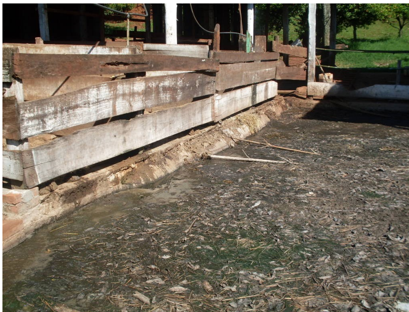
FIGURA 3. Modelo incorreto de esterqueira - instalações inadequadas
